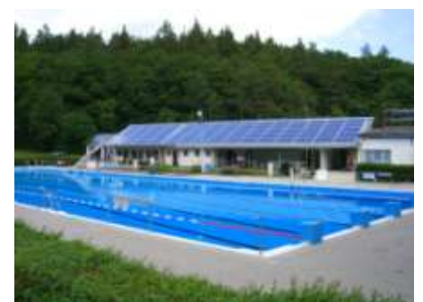
Abb. 3: Thermische Solaranlage Waldschwimmbad 4
