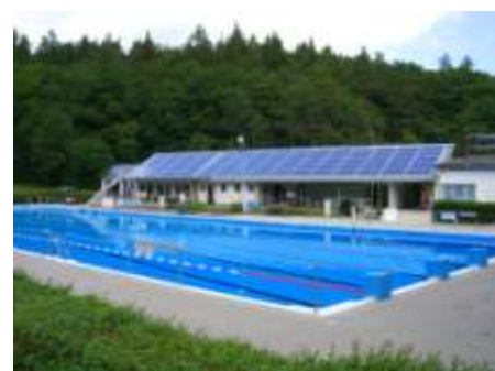
Abb. 3: Thermische Solaranlage Waldschwimmbad 4
