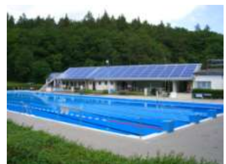
Abb. 3: Thermische Solaranlage Waldschwimmbad 4
