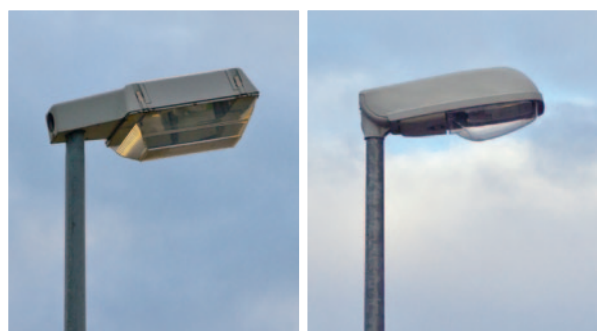
Durch die schräge Montage und die gewölbte Abdeckwanne wird unnötiges Streulicht erzeugt.
