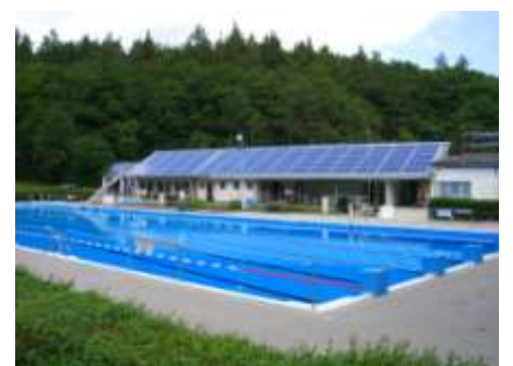
Abb. 3: Thermische Solaranlage Waldschwimmbad 4
