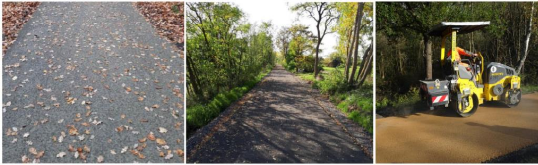
Abbildung 6: Asphaltähnliche Deckschichten aus Gemisch von Basaltstein und Spezialsanden / heller Split-Mastix-Asphalt
