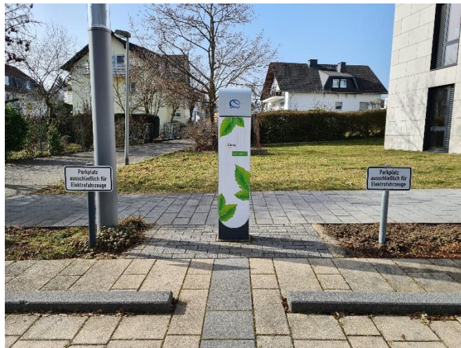
Foto 6: E-Ladesäule der Süwag mit 2 öffentlichen Stellplätzen
