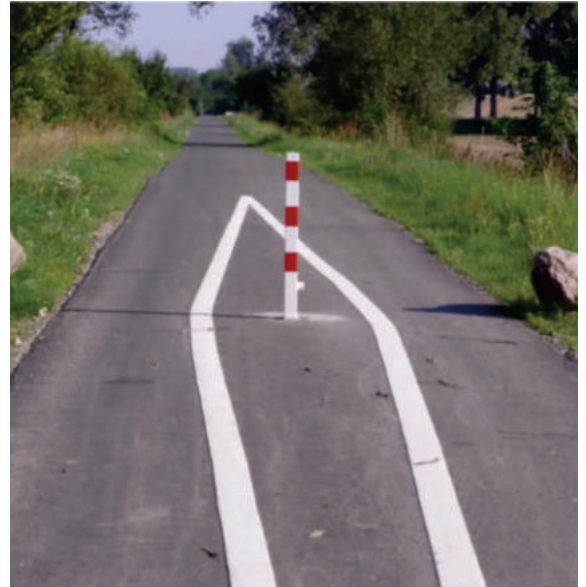
Abbildung 1: Warnmarkierung eines Sperrpfostens
