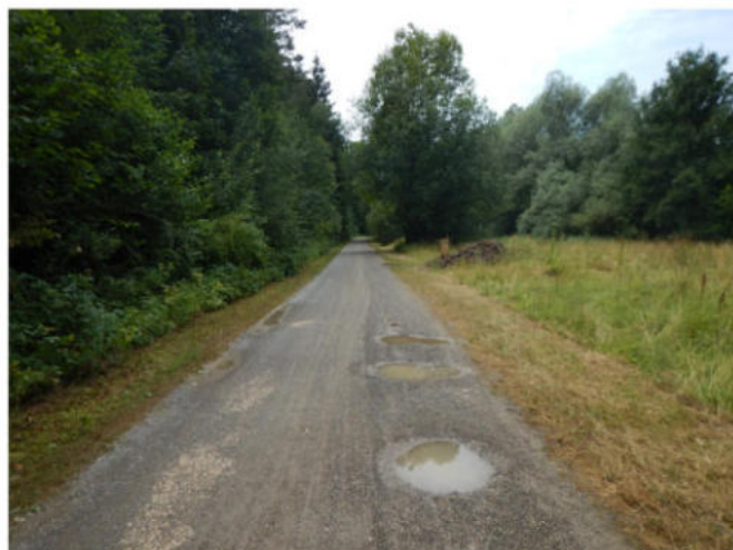
Abbildung 1, Negativbeispiel: Verdichteter Wassergebundene Decke mit Pfützenbildung und schlechter Wasserdurchlässigkeit
