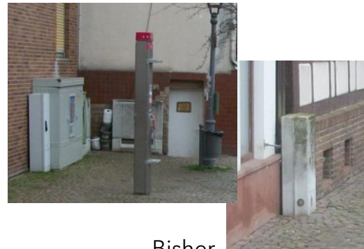
Bisher diverse Stromhausanschlusskästen rund um den Marktplatz
