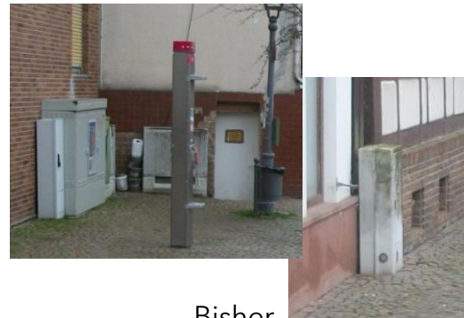
Bisher diverse Stromhausanschlusskästen rund um den Marktplatz
