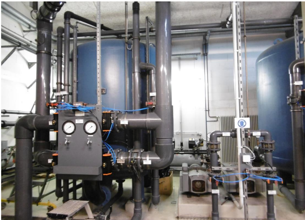
Abbildung 3: Bestehende Filteranlage des Planschbeckens
