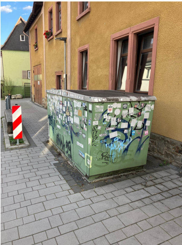
Ansicht des Trafos
