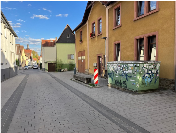
Ansicht des Trafos
