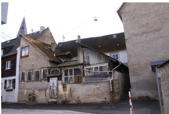
Hoher Sanierungsbedarf in der Zangerstraße
