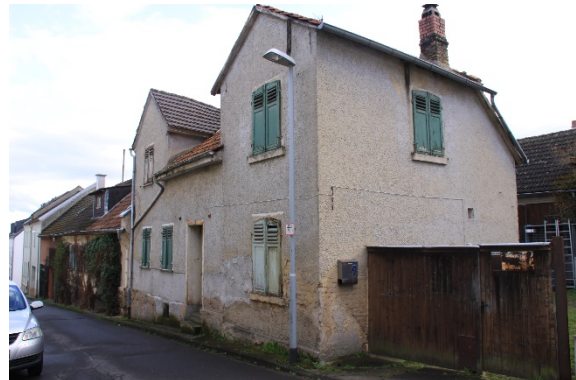
Sanierungsbedürftige historische Bebauung in der Straße An der Hochstätt
