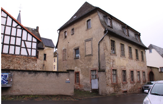
Ehemaliger Steinheimer Hof, Einzelkulturdenkmal mit hohem Sanierungsbedarf
