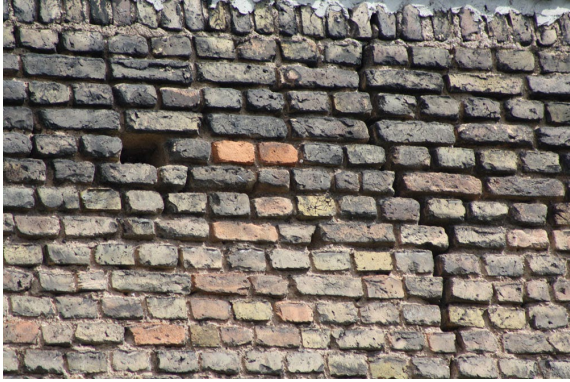
Abb. 4: Ein Riss entlang der Südfassade, der Fledermäusen Quartierspotential bietet.
