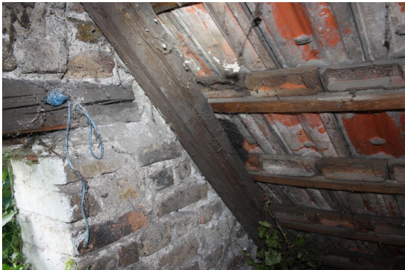
Abb. 16: Neben dem Zugangstor befindet sich ein Hausrotschwanznest auf einem Dachbalken.
