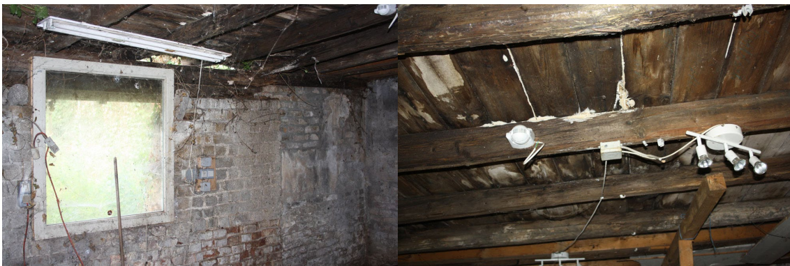
Abb. 21: Das Dach des Gartenhauses weist zahlreiche Feuchtesch den auf und ist morsch.
