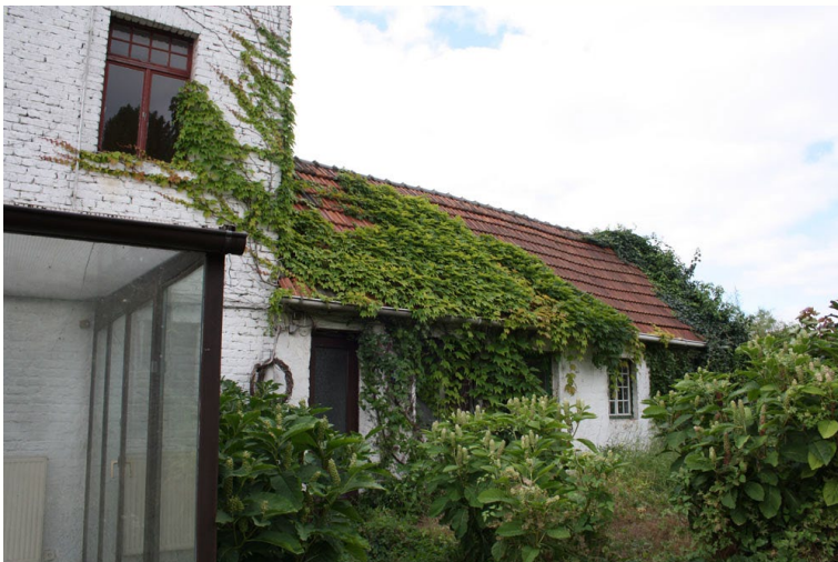
Abb. 29: Am Wohn- (A) und besonders am Nebengebäude (B) wachsen Efeu und Jungfernebe die Fassade und Dächer empor.
