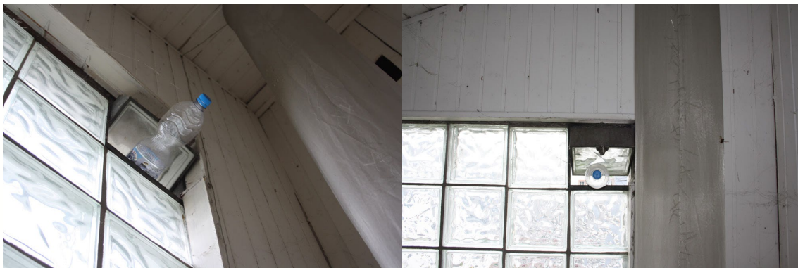
Abb. 9: Ein geöffnetes Glasbausteinfenster an der Ostfassade bietet Vögeln und Fledermäusen Einschluflmöglichkeiten in das Gebäude.
