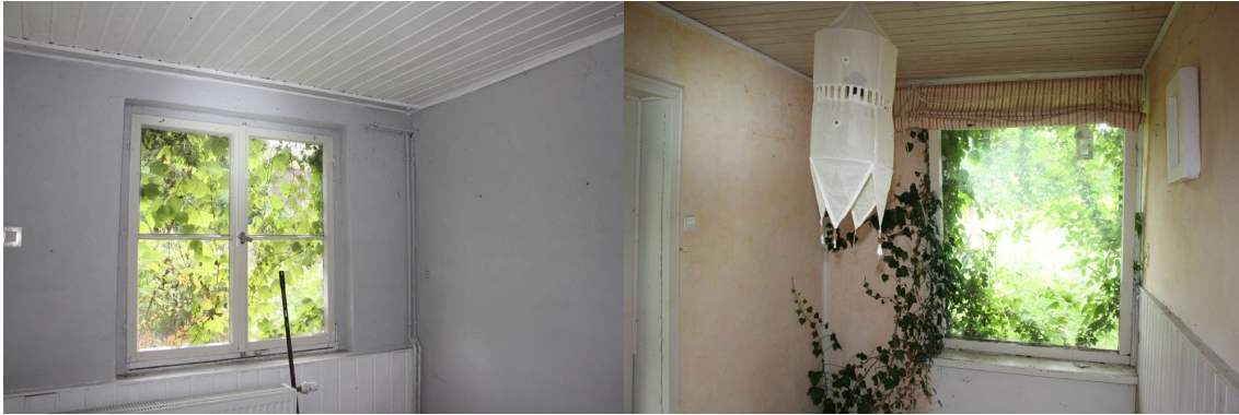
Abb. 18: Die Fenster sind intakt stehen jedoch zum Teil offen.
