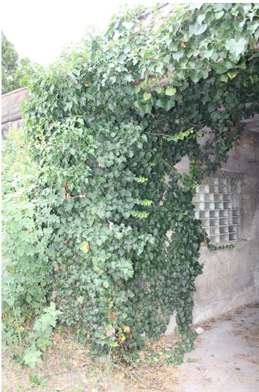
Abb. 30: Auch an dem Gartenhaus (C) und dem PKW-Unterstand (D) ist dichter Efeubewuchs vorhanden.
