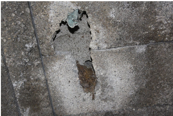
Abb. 25: Ehemaliges Haussperlingsnest in einem beschädigten Betonhohlstein in der Decke.
