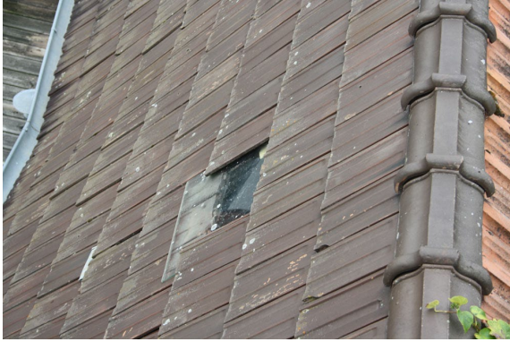
Abb. 15: Die Fenster – lichtdurchlässige Glaziegel - im Dach sind dicht und lassen keinen Einschlupf zu.
