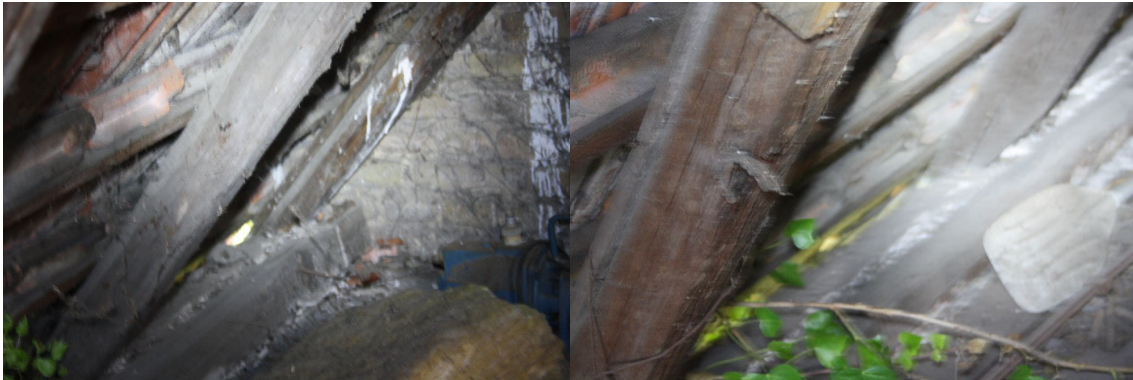
Abb. 15: Am Dachrand befinden sich Einschlupfmöglichkeiten
