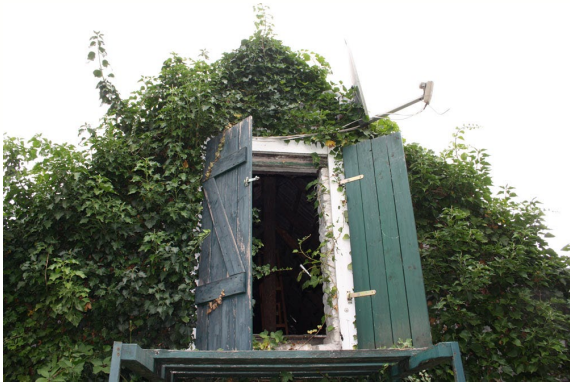
Abb. 13: Auf den Dachboden gelangt man über eine Leiter durch ein Tor, das an der westlichen Giebelseite gelegen ist. Dieses steht offen und lässt Tieren somit einen Einschlufl auf den Dachboden zu.
