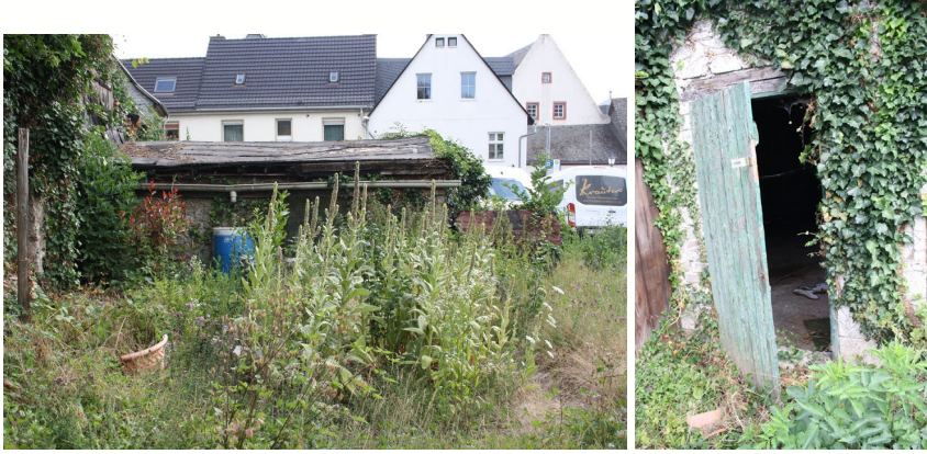
Abb. 19: An der Nordseite des zu untersuchenden Grundstücks befindet sich ein baufälliges Gartenhaus.
