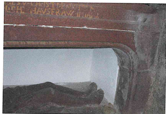
Abb. 5: Salzausblühungen als primär optische Beeinträchtigungen führen langfristig zu Stein-schäden.
