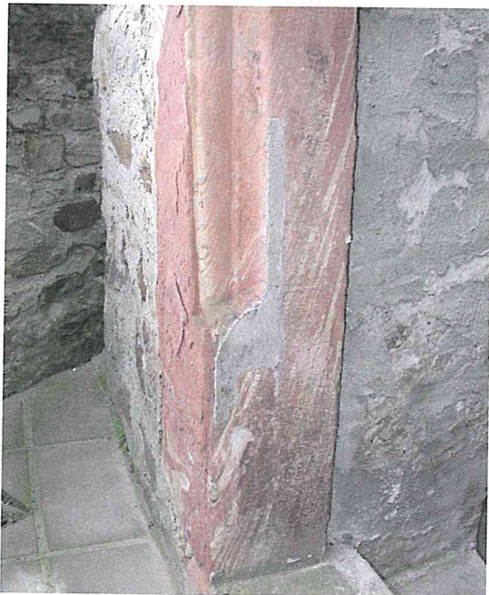
Abb. 2: Zementausbesserungen auf Sandstein, Einsatz von wahrscheinlich Trasskalk im Innenbereich.
