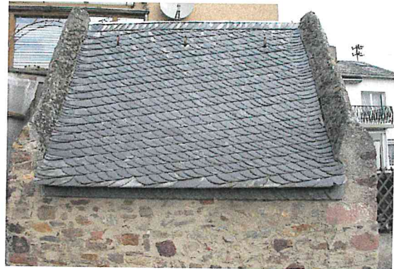
Abb. 4: Dachkonstruktion anfällig gegenüber eindringendem Regenwasser (über gerissen Mörtel innerhalb der Seitenteile).
