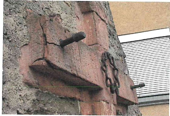
Abb. 3: Kreuz aus Sandstein infolge Rostsprengung und Frosteinwirkung stark gerissen.
