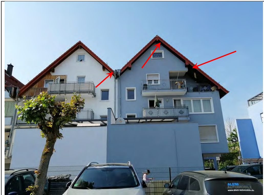
Abbildung 9: Rückseite der jüngeren Wohn- bzw. Mischbebauung im südwestlichen Änderungsbereich mit bedingtem Nistpotenzial an Dachüberständen
