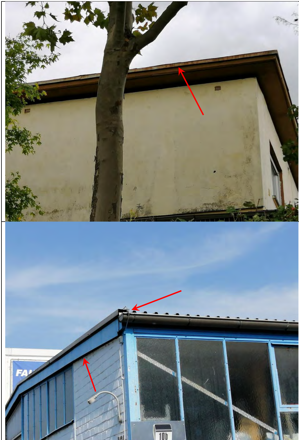
Abbildung 10: Beispiele für Gebäudespalten mit geringem Quartier- oder Nistplatzpotenzial
