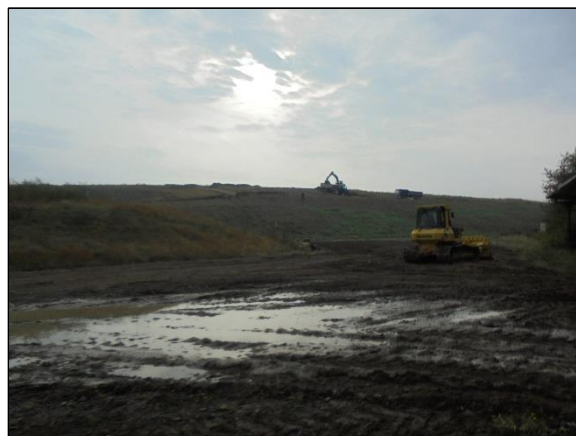
Abb. 4: Durch Rekultivierungsarbeiten entstandene Bodenschäden im Bereich der stationären Brech- und Klassieranlage..
