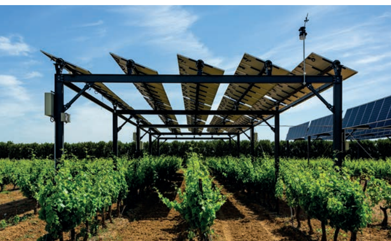
Abb. 26: Agri-PV mit nachgeführten Modulen in Frankreich. © Sun'Agri
