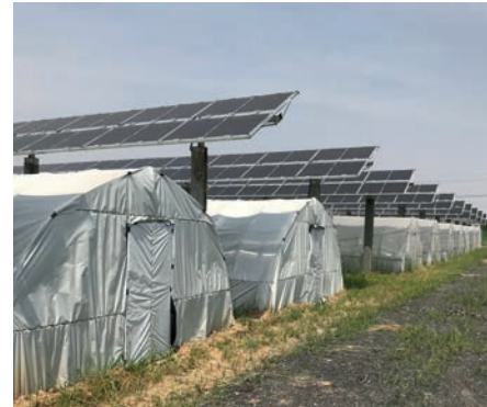
Abb. 40: PV-Module über einem Folientunnel. © BayWa r.e.
