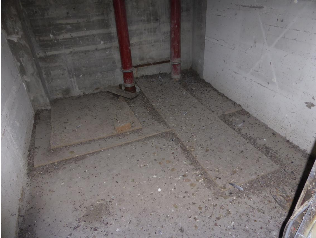
Abb. 11: Versorgungsschacht mit Resten von Taubenkot
