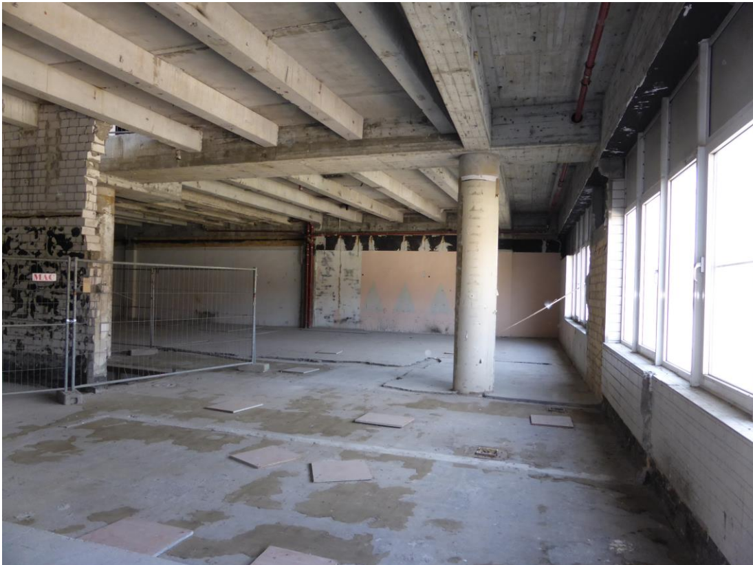
Abb. 10: Leer stehende, entkernte Innenräume, geschlossene Fenster
