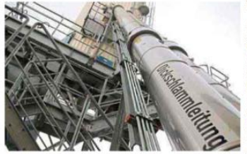
Die Zusammenarbeit wurde auf die Entsorgung von Klärschlamm, Rechen- und Sandfang ausgeweitet. FOTO: IKZ
