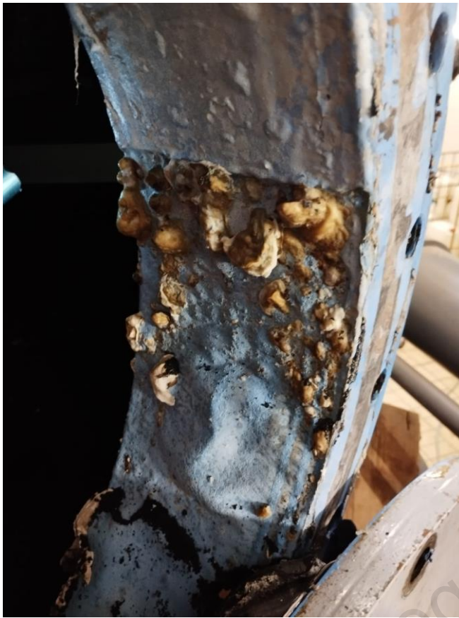
Ablagerungen am Mannloch (Wartungsöffnung am Filter)
