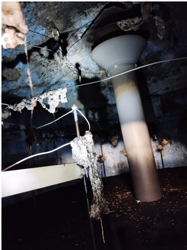
Ablagerungen im Schnelldruckfilter
