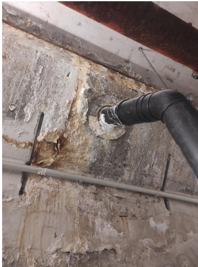
Abplatzungen Beton Schwimmbecken Technikkeller
