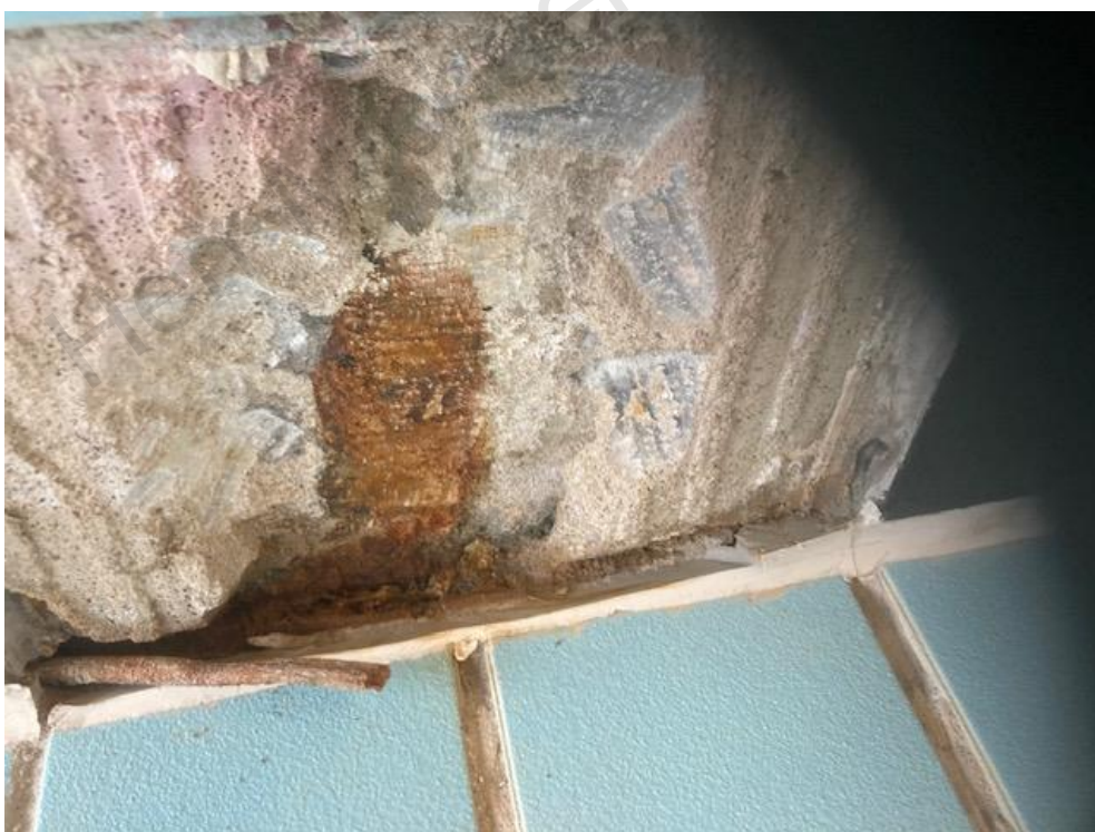
Bewehrungskorrosion Beton Schwimmbecken Innenseite
