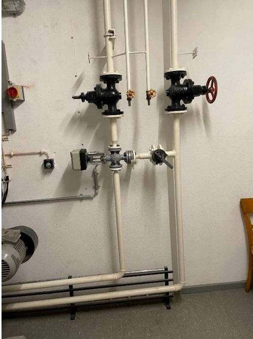
Erhitzeranschluss dez. Lüftungsgerät
