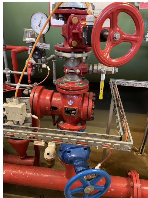
Verteileranschluss Ventilstation Gasse 1
