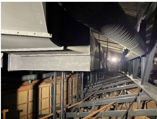
Abluftleitungen im Dachraum
