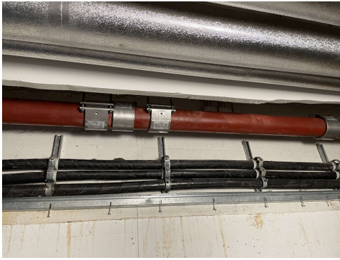
Rohrbruchschellen an defekter Sprinklerleitung
