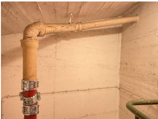
Regenwasserleitung im Treppenhaus
