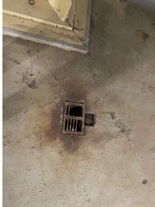
Bodenablauf in Technikzentrale
