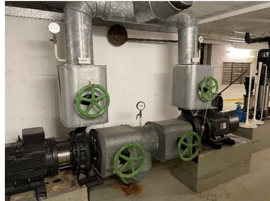
Umwälzpumpen Kälte (Kondensator/Brunnenwasser)
