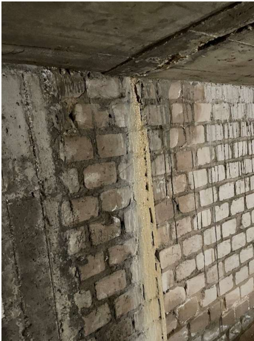
Außenluftansaugkanal (Bauschaden, Wassereintrag)
