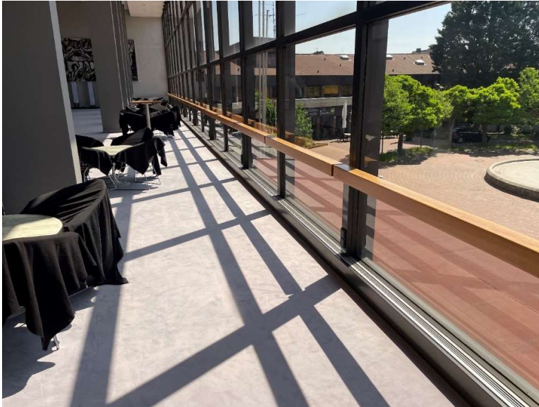
Zuluftauslass Fassade Foyer
