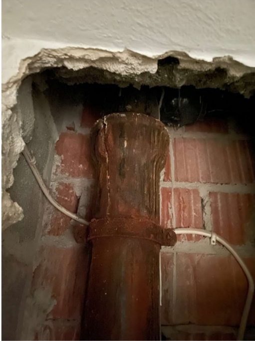
Schmutzwasserleitung im Schacht
