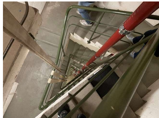
Regenwasserleitung im Treppenhaus
