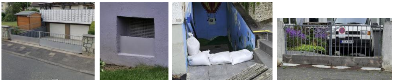
Abbildung 21: Bereits vorhandene einfache Objektschutzmaßnahmen
