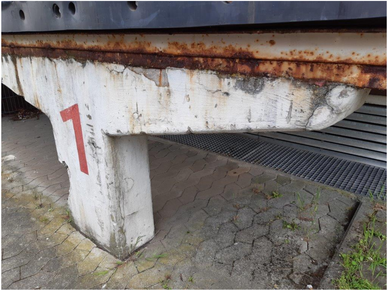
Stark geschädigte Rampe an der Hinterbühne, hier ist eine Betonsanierung erforderlich, die Stahlträger müssen entrostet und mit Rostschutz beschichtet werden.
