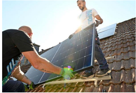
Abb. 9 Solaranlagen sparen CO 2
