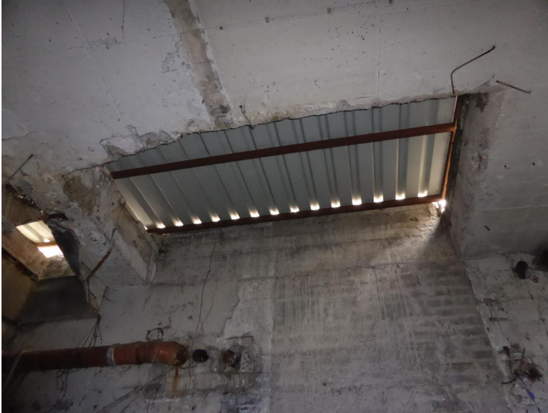
Abb. 9: Lose Blechabdeckung hinter dem Karstadtgebäude, vom Keller aus gesehen. Einziger theoretischer Zugang für Tiere von außen
