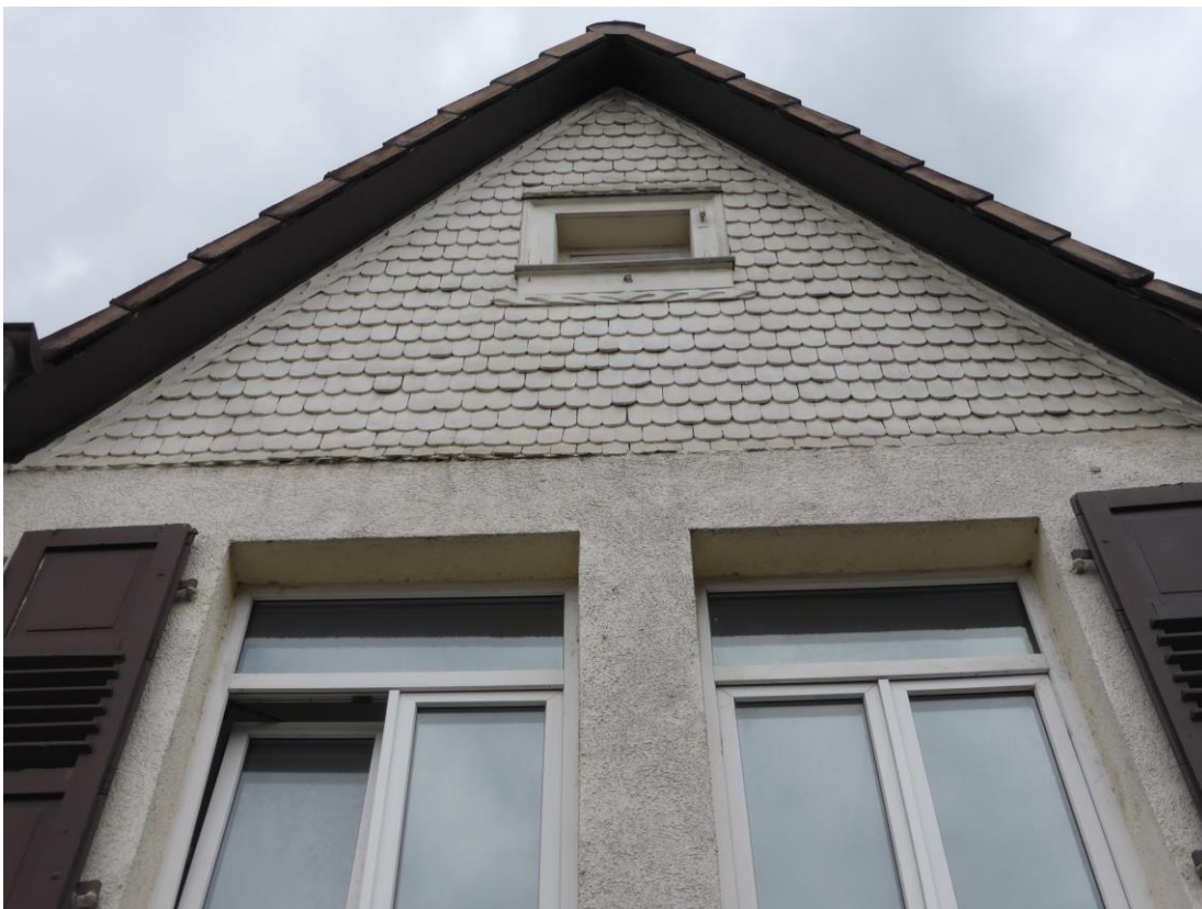
Abb. 18: Mit Schindeln verkleideter Giebel des Gebäudes am Friedensplatz zur Frankfurter Straße hin. Keine hinterfliegbaren Lücken.
