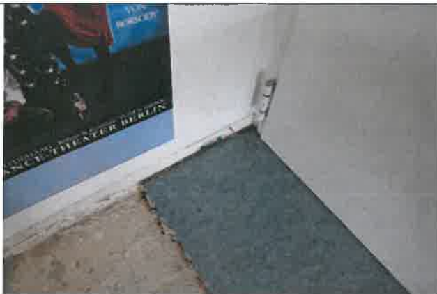
Foto 3: wie Foto 1, der Estrich hinter der Zugangstür wurde nicht vollständig entfernt
