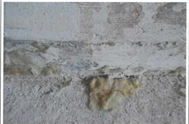
Foto 2: wie Foto 1, Reste von KMF im Anschlussbereich Boden/Wand
