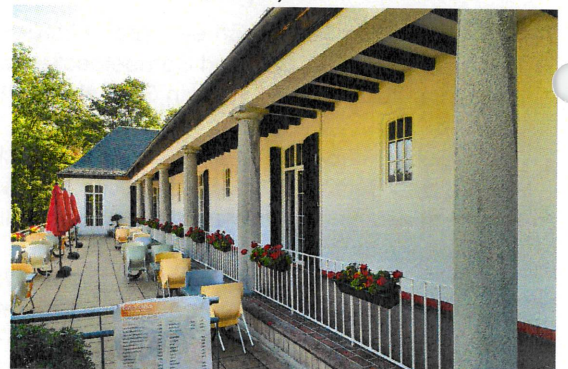
Thermalfreibad, Nassauer Allee 1, Kolonnade von Westen, Zustand September 2022 (Foto: Christine Krienke, LfDH)
