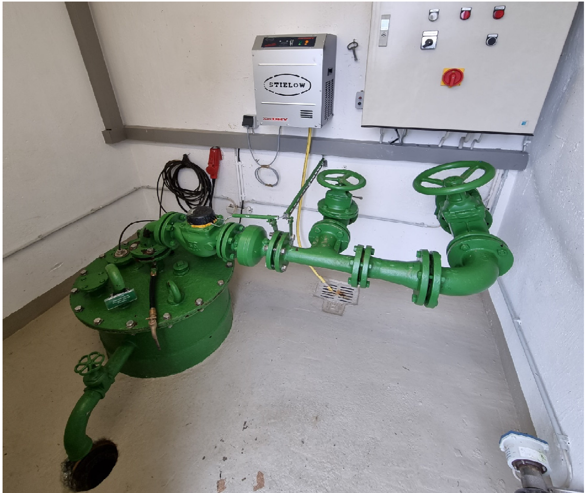
Abb. 4: Brunnenkopf mit Überlauf, hydraulische Installation
