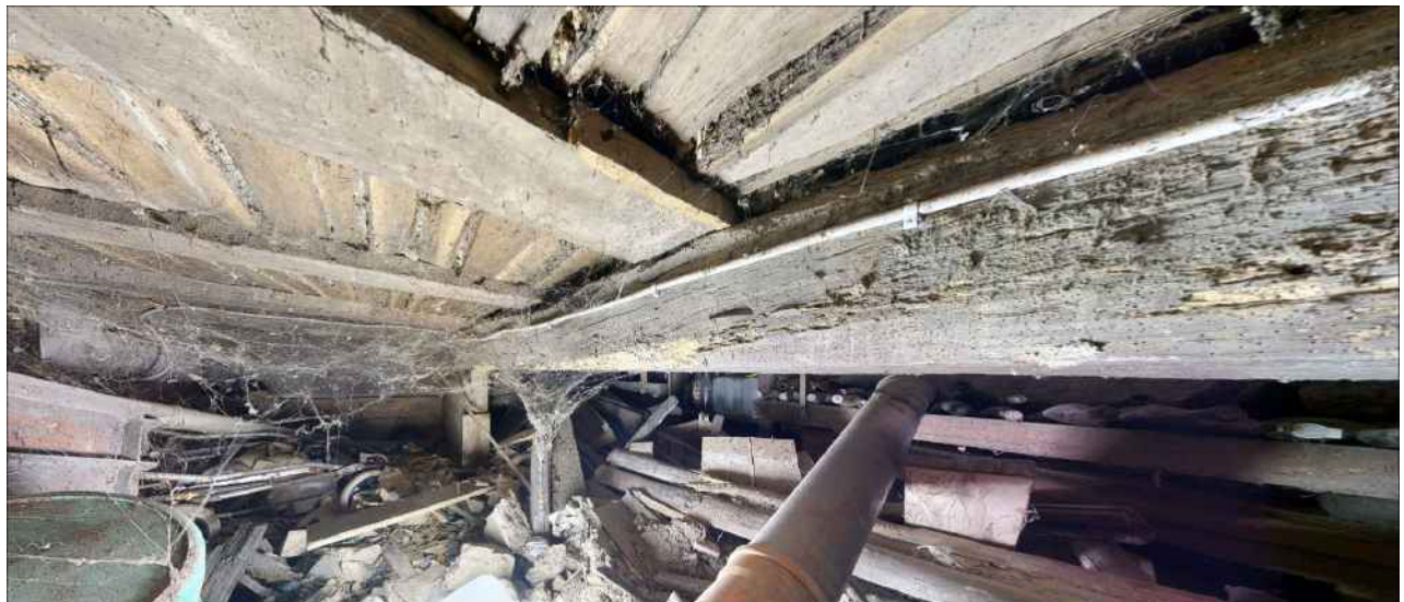
Abb. oben links: Kellerfenster, erste Hälfte 20.Jh. Abb. rechts: Südlicher Kellerraum; durch Pilzbefall geschädigte Balkendecke unter ehem. Bad Abb. unten links: Nördlicher Kellerraum; oberflächlich durch Holzwurm geschädigte Balkendecke
