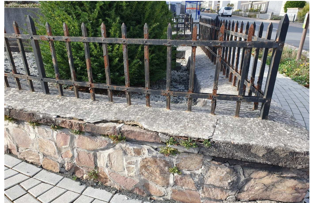
Umlaufende Mauerabdeckung defekt
