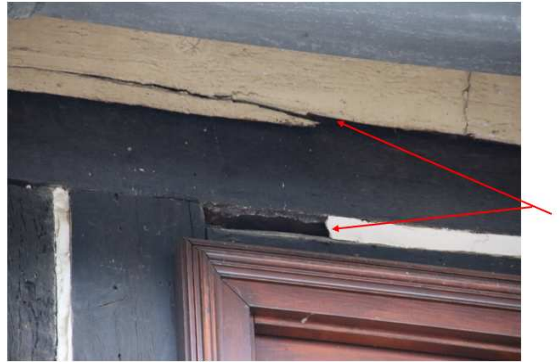
Abb. 6: Ansicht auf das Brett zum Übergang zwischen Dach und Fassade, dies ist ebenfalls kaputt. Des Weiteren ist ein Teil des Fachwerks in diesem Bereich bereits rausgefallen.
