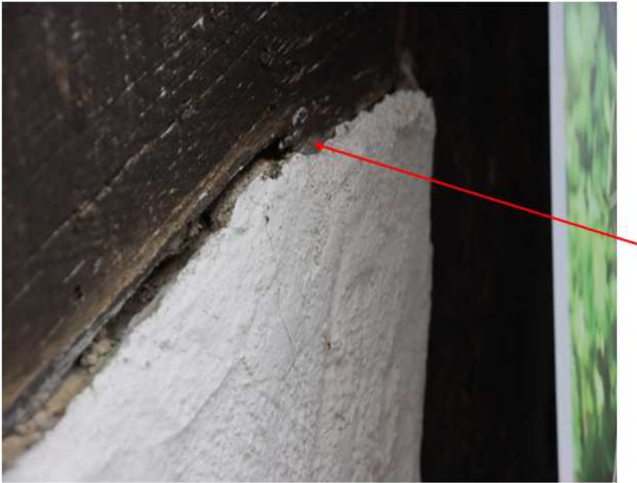
Abb. 7: Detailansicht auf ein Fachwerkfeld welches sich bereits gelöst hat.
