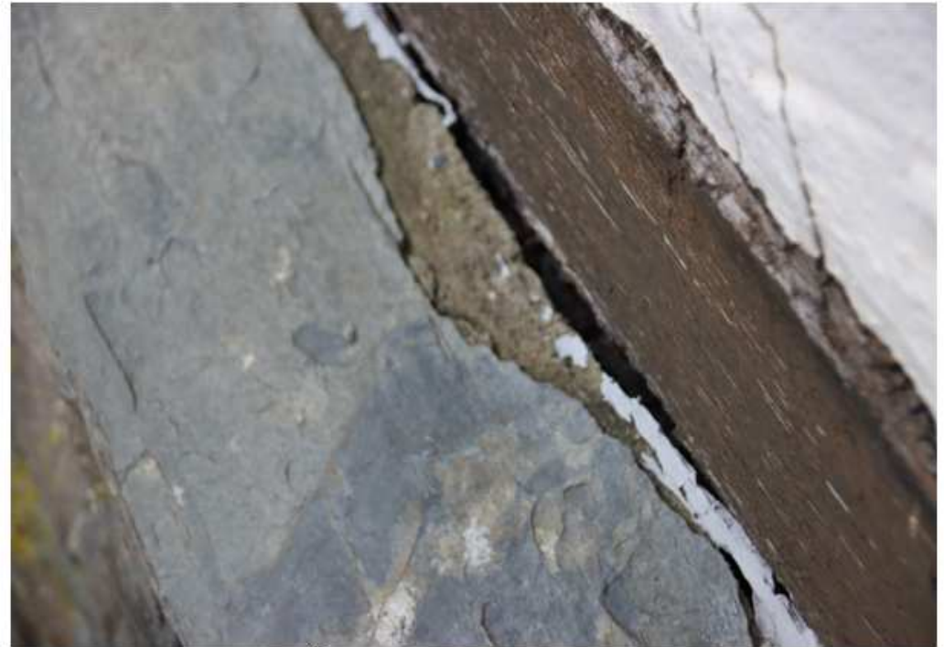
Abb. 8: Detailansicht auf den Übergang zwischen Fassade und Sockel. Die Fuge ist marode und es kann Wasser hinter den Sockel eindringen.
