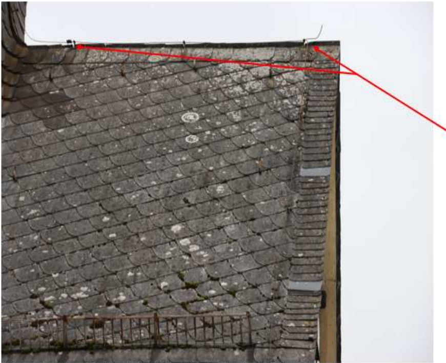
Abb. 3: Ansicht auf fehlende Schiefersteine im Firstbereich des Daches.
