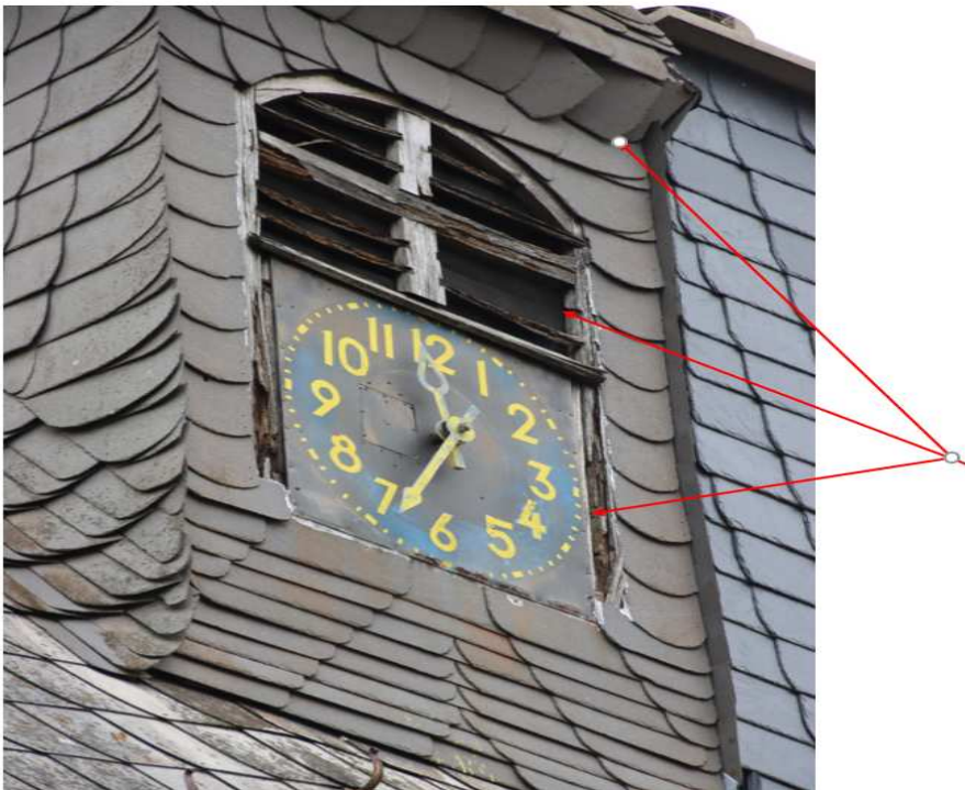
Abb. 1: Ansicht auf den Glockenturm mit den weggefallenen Querstreben, der maroden Ziffernplatteinfassung und den losen Schieferplatten.
