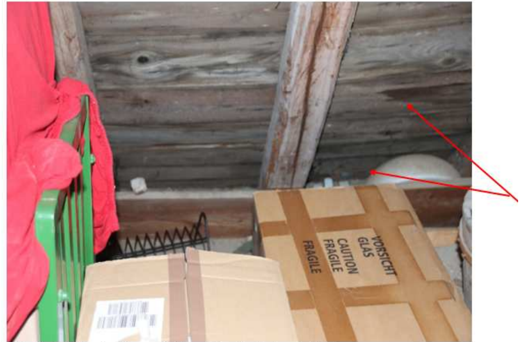
Abb. 4: Ansicht auf weitere undichte und feuchte Stellen des Daches.
