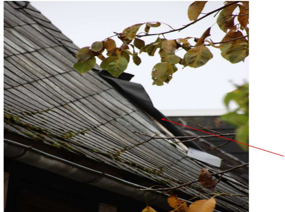
Abb. 2: Ansicht auf den notdürftig mit Dachpappe reparierten Dachbereich auf der westlichen Dachseite der Alten Schule.
