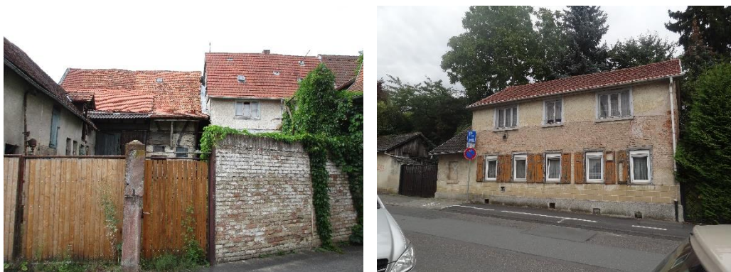
Abb. 13: Beispiele für Gebäude mit erheblichem Modernisierungsbedarf, eigene Aufnahme werkplan, August 2021
