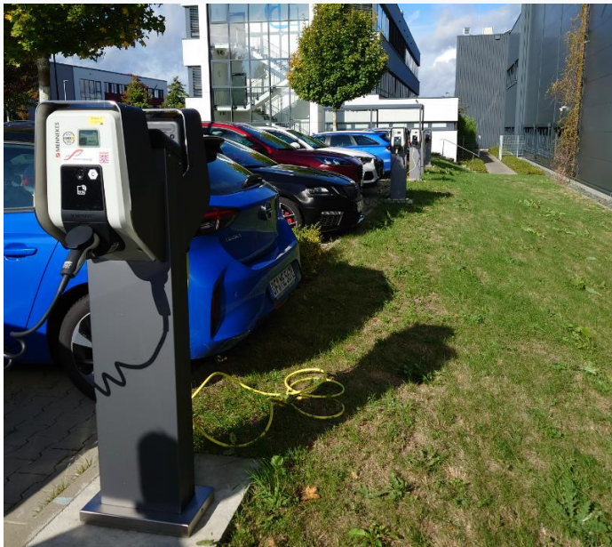
Ladeinfrastruktur auf dem Parkplatz von Adam Hall
