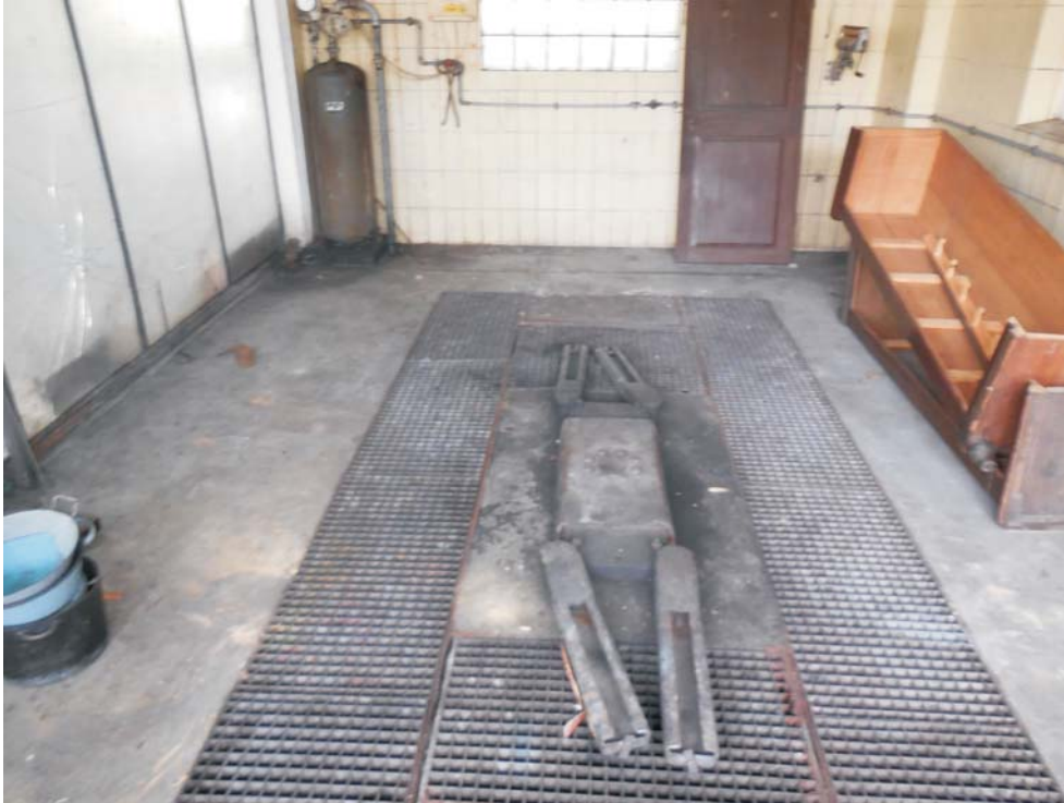
Bild 03: Blick auf die Hebebühne (Blickrichtung: Süd, Aufnahmedatum: 07.04.14)
