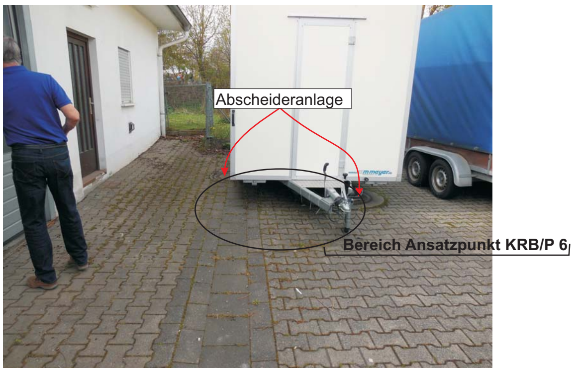
Bild 02: Blick auf die angetroffene Abscheideranlage (unter dem Anhänger) (Blickrichtung: West, Aufnahmedatum: 07.04.14)
