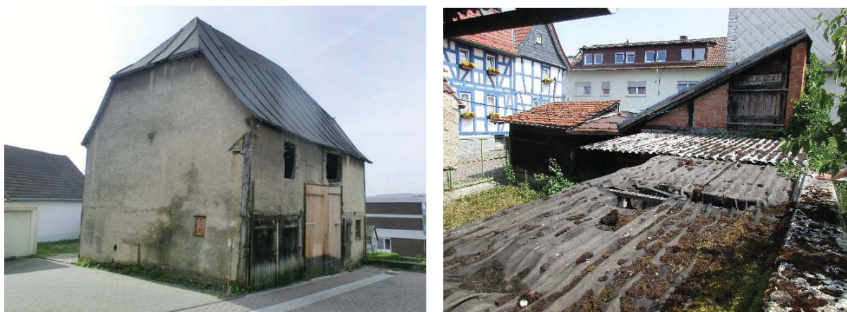
Abb. 28: Beispiele für abgängige Gebäudesubstanz bei Nebengebäuden
