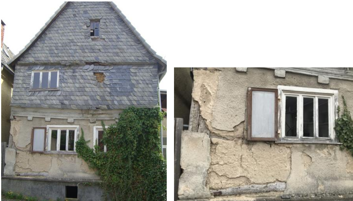
Abbildung 68: Leerstehendes Baudenkmal mit erheblichen baulichen Mängeln
