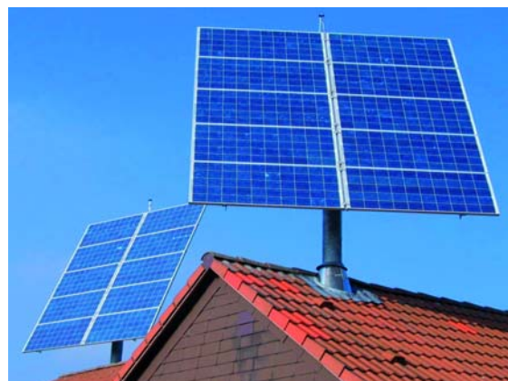
Abb. 25: So bitte nicht! © Firma Roto Dach- und Solartechnologie GmbH
