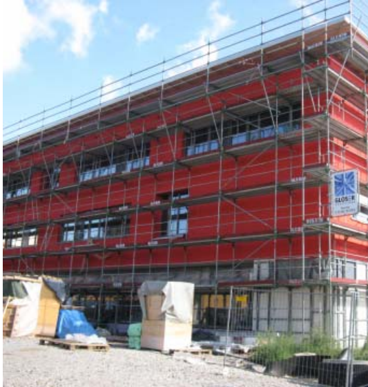
Abb. 14: Neubau in Passivhausbauweise in Frankfurt am Main, © Magistrat der Stadt Frankfurt am Main
