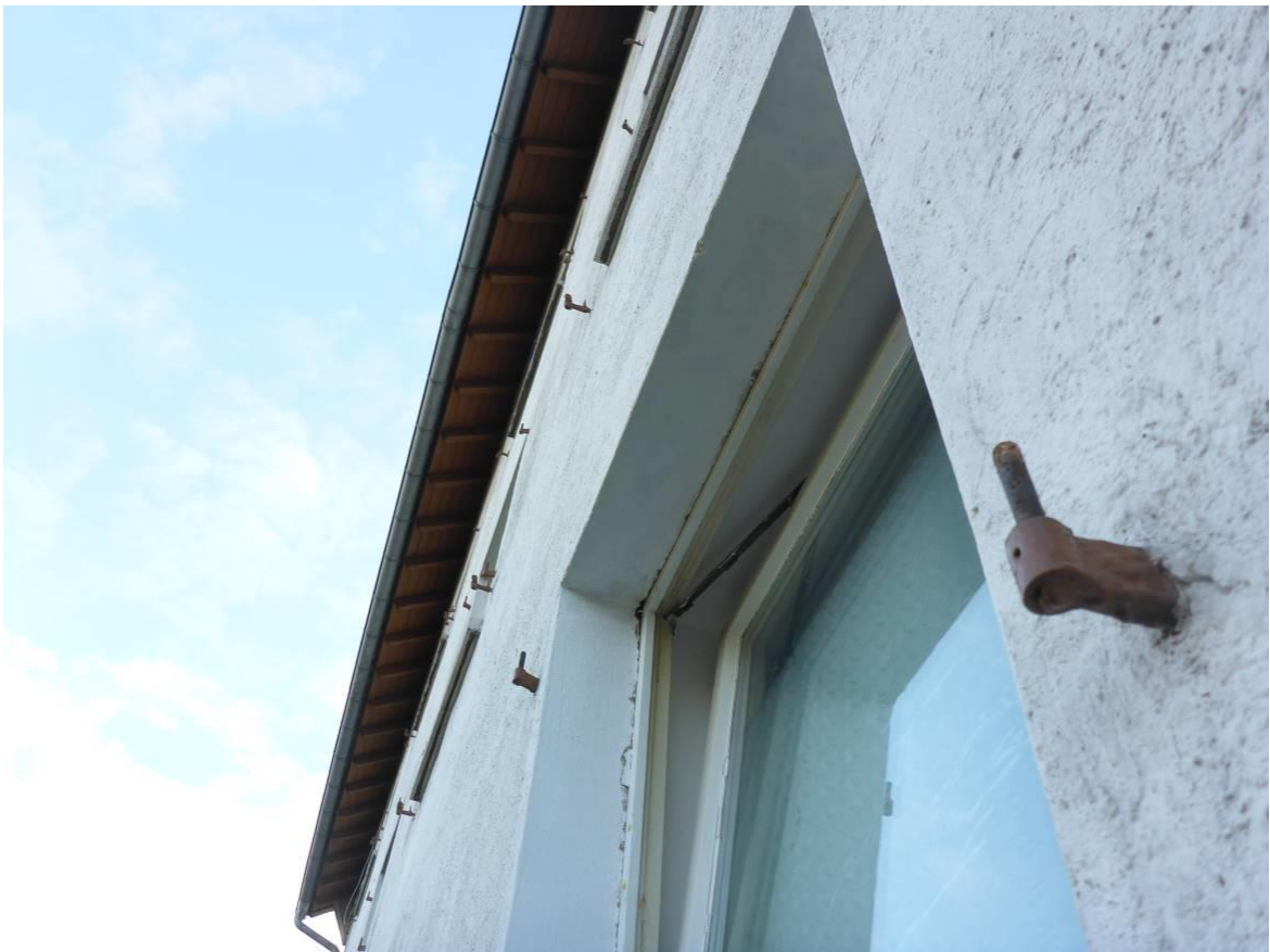
Abb. 16: Auch im Bereich der Fenster fanden sich aufgrund des Fehlens von Rollladenkästen und Fensterrahmen keine möglichen Spaltenquartiere für Fledermäuse.
