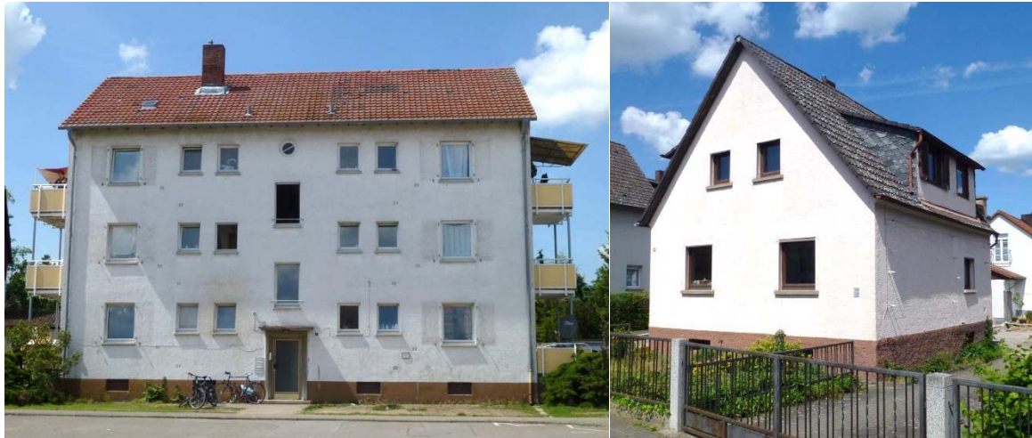
Abb. 8: Gebäude mit deutlich sichtbaren baulichen Schäden und umfassendem Sanierungsbedarf. (Quelle: Fotodokumentation)
