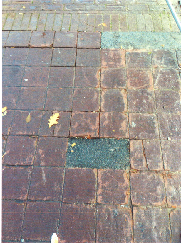
06 Beispielhafter Schaden b IMG_0036.JPG
