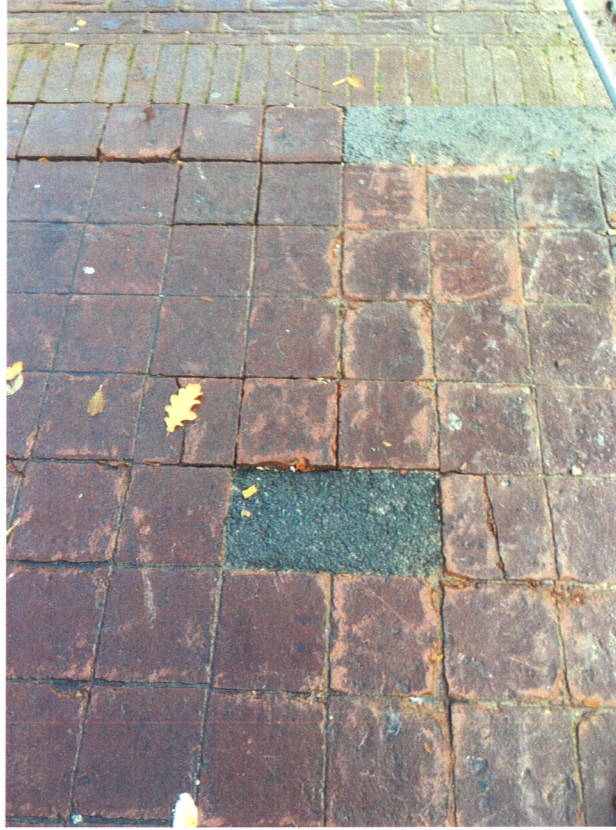
06 Beispielhafter Schaden b IMG_0036.JPG
