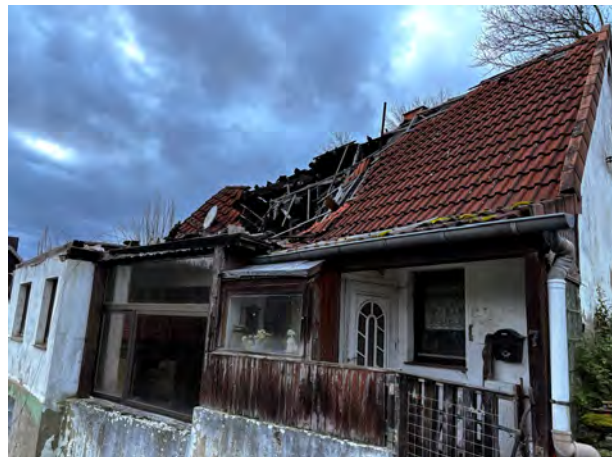
Bild 63: Brandruine in einem Stadtteil der Stadt Volkmarsen
